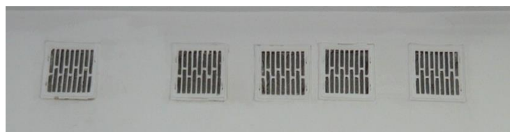
Fot. 1. Widok kratki wentylacyjnych w pomieszczeniu Phot. 1. View the ventilation grilles in room
