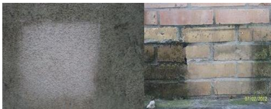
Fot. 2. Elewacje po zastosowaniu produktu biobójczego w wyznaczonych polach Phot. 2. Elevations after application of the biocidal product in the designated fields
