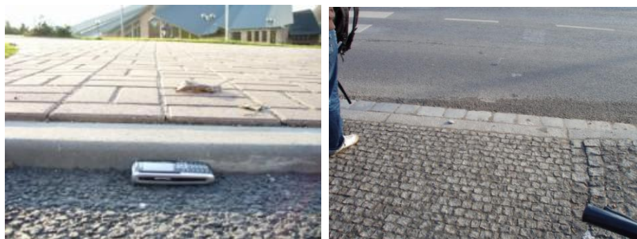
Fot. 1-2. Wysokość progu ścieżki rowerowej sprzeczna z zapisami prawnymi (Zielona Góra) i zgodna z nimi (Wrocław)
